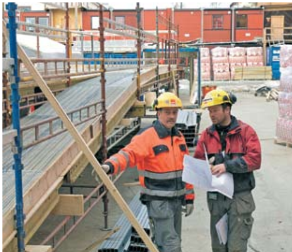
Miljøstasjonen er bygget opp med rampe opp til dekke for tømning av trallene. Svenn Are Leraand (til venstre) og Erik Hansen studerer plantegningen for 6. etasje.
